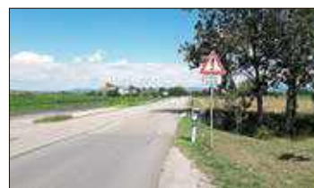
Derzeit wird an der Staatsstraße mit Gefahrenzeichen auf die Fahrbahnschäden hingewiesen. Foto: Staatliches Bauamt Passau
